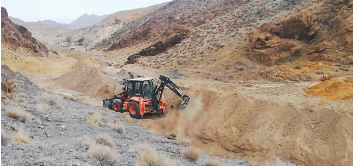
شکل ۱۲. عملیات احداث بند انحرافی و ایجاد آبراهه برای محافظت از قنات خمسیان اشکذر.
